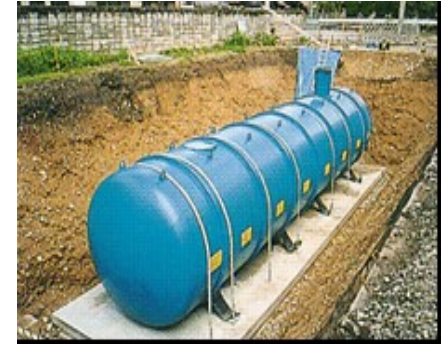
【耐震性貯水槽】
